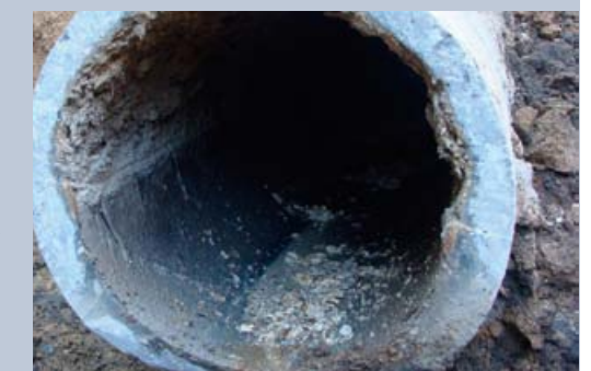
Afbeelding 7: Sectie van de buis, op 75 m van de uitloop van de persleiding, na 20 jaar dienst.
